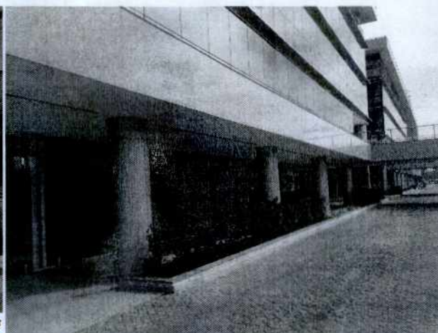
Figura 6: Espaço de galeria e livre passagem de carros em área que deveria estar aterrada. Fonte: Assessoria Técnica - Vistoria em 2/6/2016
