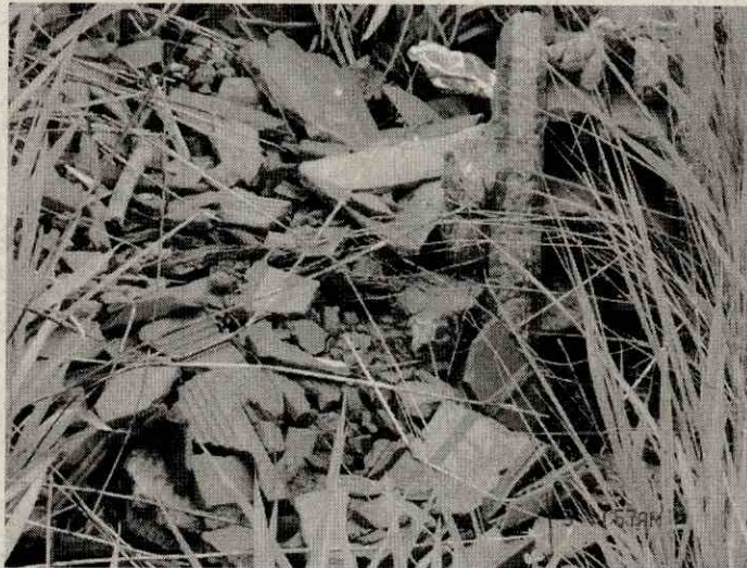
Figura 02 – Presença de Entulho
